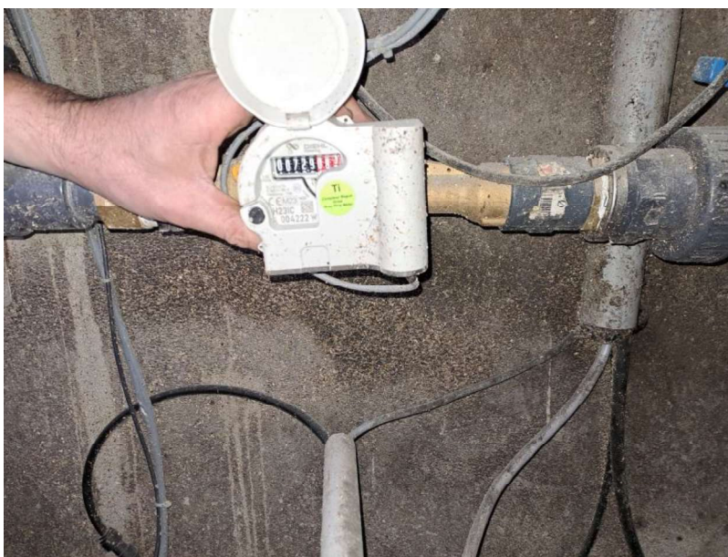
Photographie 3 : Nouveau compteur d'eau (mis en place le 10/11/2023)
